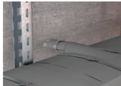
Кабельный вывод с бандажированием.
