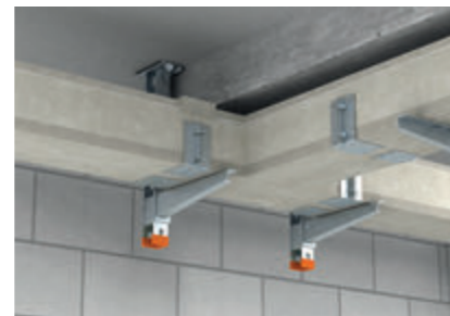
Предварительно смонтированные стандартные фасонные детали в трассах.
