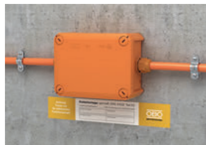
Установленная огнестойкая распределительная коробка FireBox с маркировкой.
