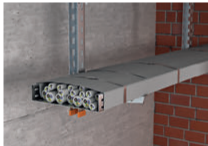
Полное бандажирование подвесной кабельной трассы.
