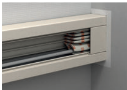
Расположенные в кабельном коробе подушки.
