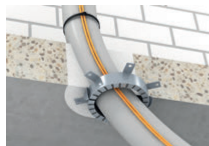
Трубы пневмопочты с двумя сопутствующими кабелями.
